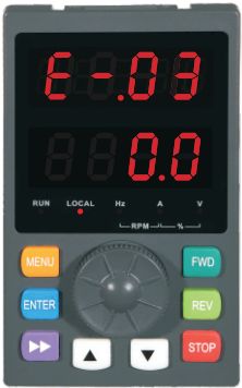
图4-5 故障告警显示状态
